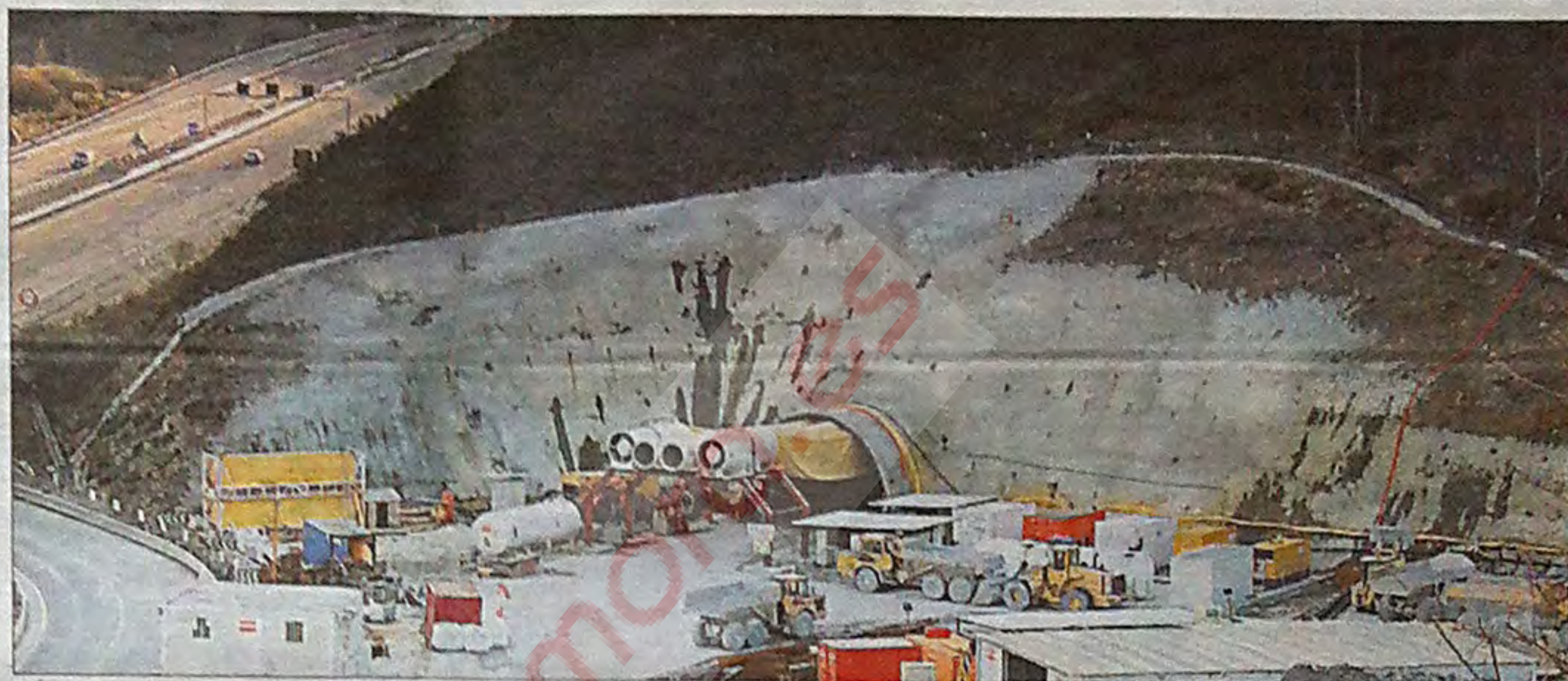
TÚNEL DE LA CANDA DESDE EL LADO GALLEGO. La dificultad se multiplica en el tránsito de la provincia de Zamora a la de Orense. Aquí, el túnel de La Canda (visto desde Galicia) une a las dos regiones. | FOTO TREN ZAMORA
